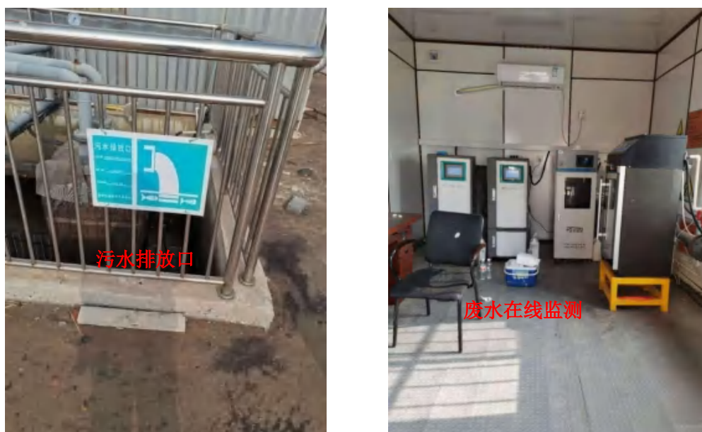
图 4.3-2 废水排放口、在线监测
