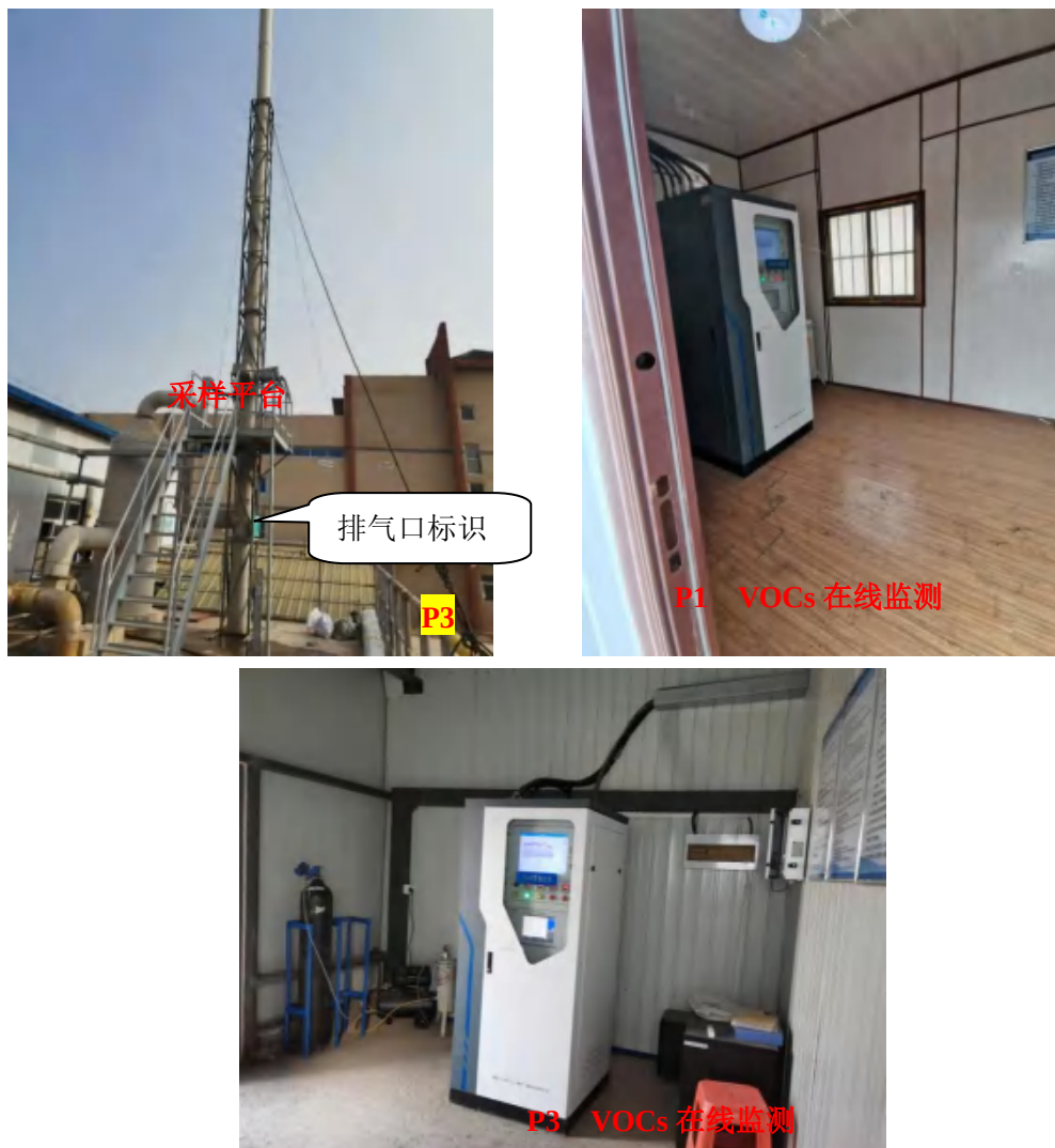
图 4.3-1 废气措施采样平台、排气筒、在线监测
