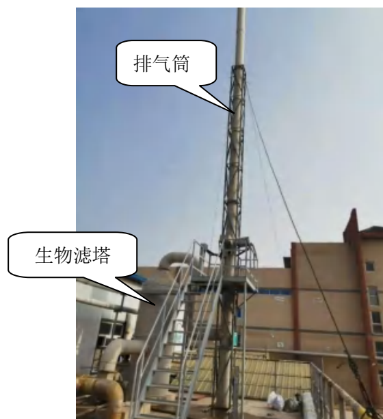
图 4.2-8 生物滤塔及排气筒
