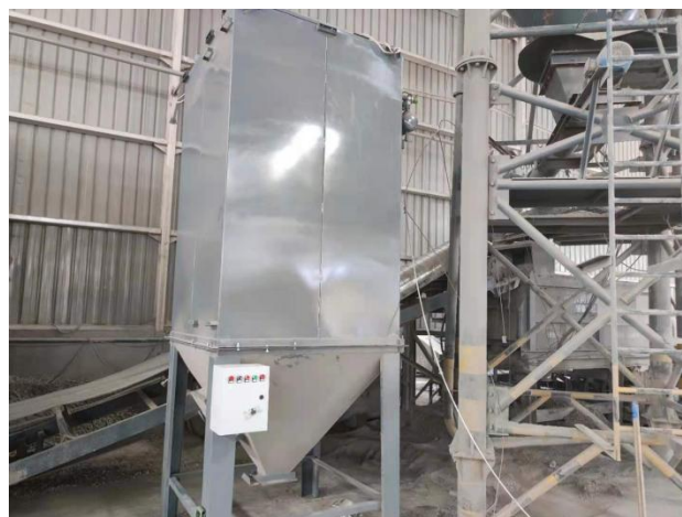
水稳搅拌 1 个布袋除尘照片
