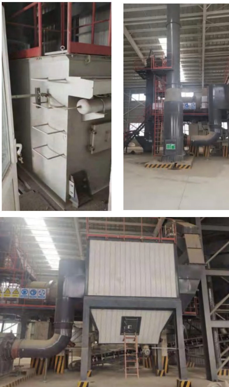
干粉砂浆砂子烘干废气 2 套布袋除尘器+排气筒（P3）照片
