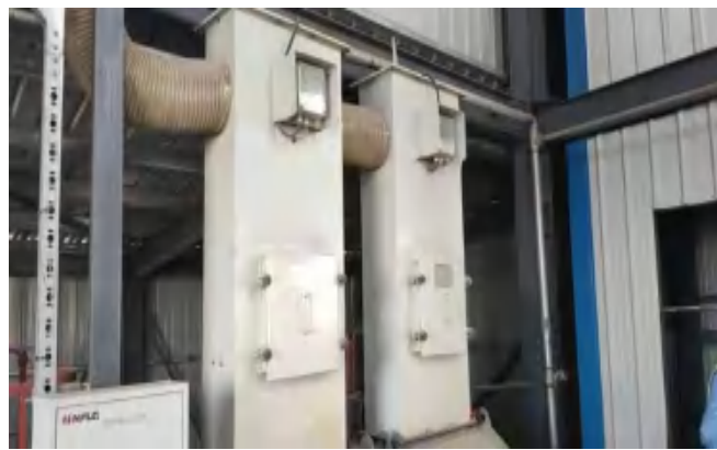
筒仓 8 套除尘器照片
