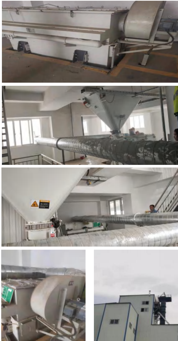
干粉砂浆生产线搅拌+成品散装废气布袋除尘+排气筒（P2）照片
