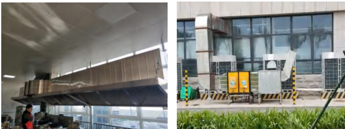
集气罩+油烟净化器+排气筒照片
