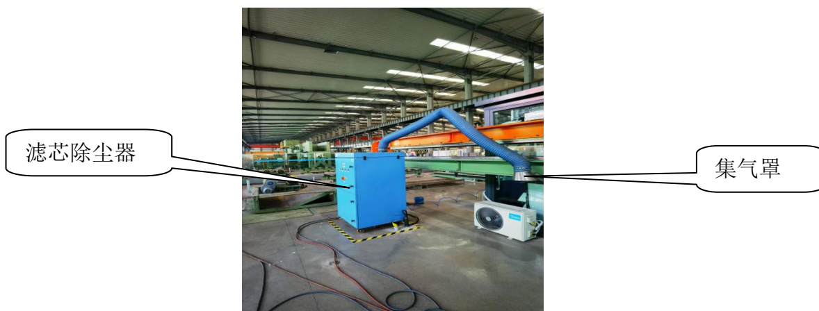
图 4.2.2-1 集气罩、滤芯除尘器
